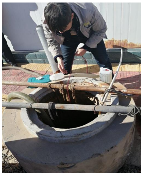
老基地地埋式生活污水处理设施
