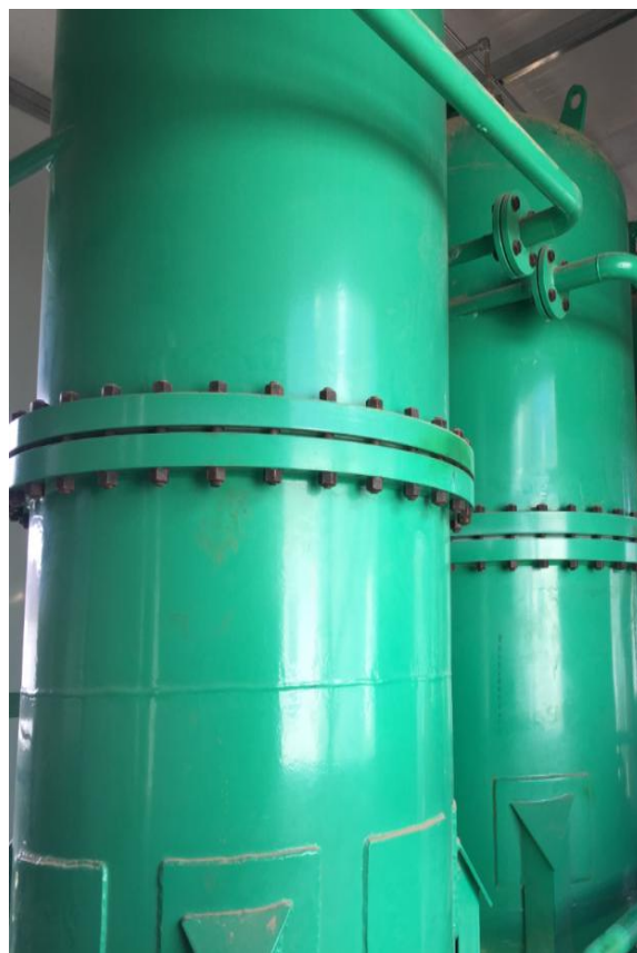
华二集输站采出水处理系统
