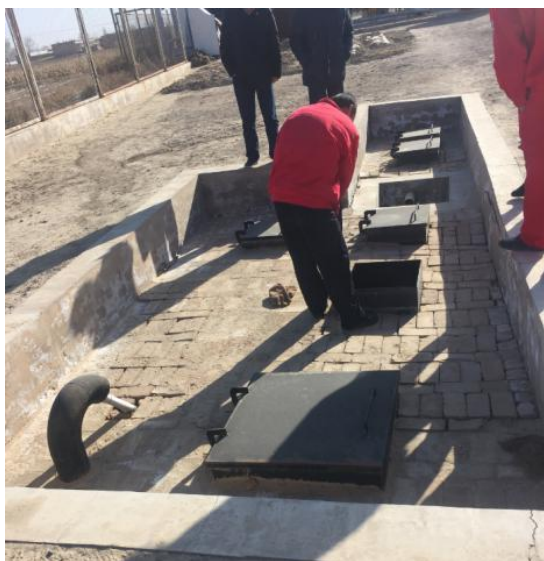
新基地地埋式生活污水处理设施
