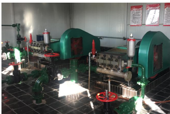
泵设备置于室内
