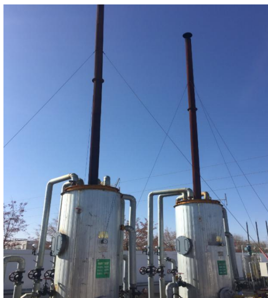
华三增压站加热炉
