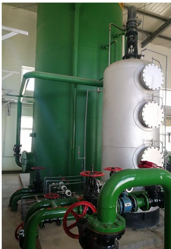
华一集输站采出水处理系统
