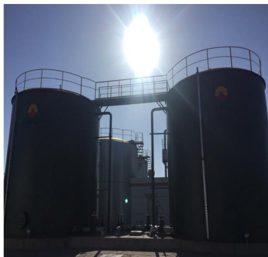
华二集输站储油罐区
