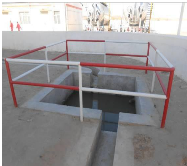
华二集输站油罐区雨水收集池
