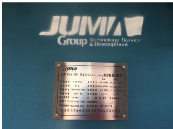
集输站加热炉铭牌
